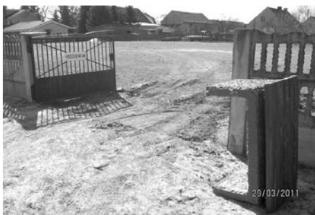
Od budowy placu minęło zaledwie 5 miesięcy... Można zadać sobie pytanie: Czy taka inwestycja musiała ulec zniszczeniu?
